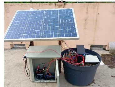
Gambar 11. Pengujian Monitoring PLTS 50Wp
