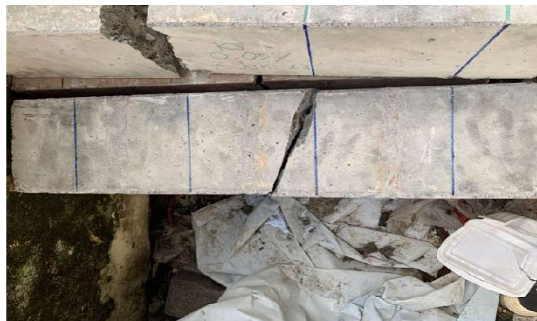
Gambar 7. Pola Retak Beton Pada Pengujian Kuat Tarik Lentur
