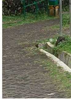
Kondisi jalan Kampung Topeng
