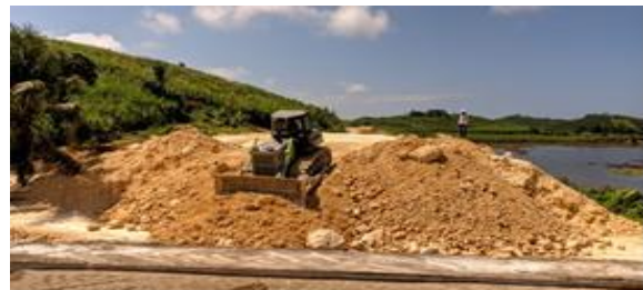
Gambar 4.2 urugan tanah di STA 1+800
