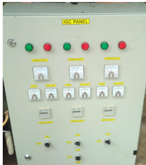
Gambar 9. Panel box (instalasi output /daya yang dihasilkan)
