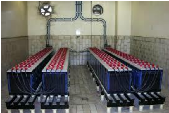
Gambar 9. Ruang Baterai di Gardu Induk
