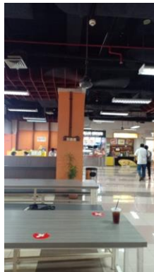
Gambar. 7 Posisi Kipas Angin Plafon dari Lantai Sumber: Survei Lapangan, Januari 2024
