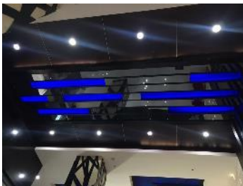
Gambar 17. Lampu downlight pada area lobby (dokumentasi pribadi, 2019)
