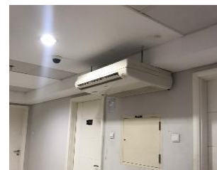
Gambar 27. Penggunaan AC ceiling mounted (dokumentasi pribadi, 2019)
