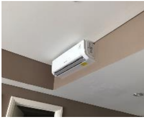
Gambar 28. Penggunaan AC split pada kamar apartemen (dokumentasi pribadi, 2019)
